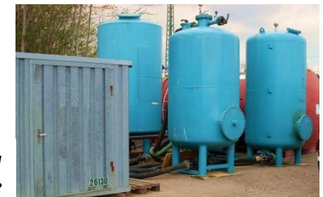
Bild oben: Rohwasser der Bauwasserhaltung Bild unten: Bauwasseraufbereitungsanlage
