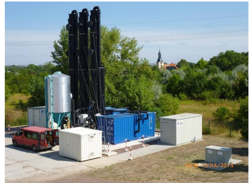
Abbildung 1: Grundwasserreinigungsanlage in Schkopau
