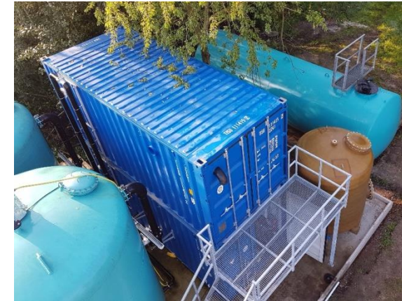
Abbildung 1: Anlage zur LHKW-Entfernung durch Wasseraktivkohleadsorption mit vorgeschalteter Kiesfiltration
