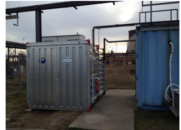
Abluftreinigung Schwarze Pumpe
