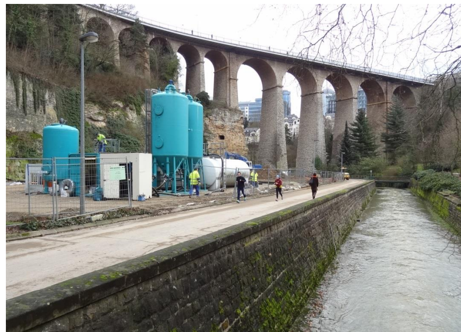
Anlage zur Reinigung von BTEX und PAK
