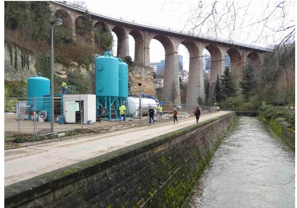
Abbildung 1: Anlage zur Reinigung von BTEX und PAK
