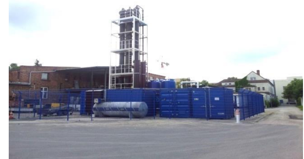
Abbildung 1: Anlage in der Kanalstraße
