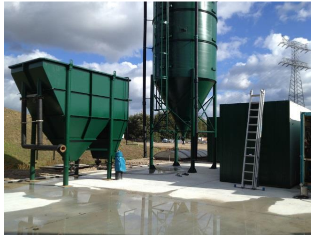
Abbildung 1: Grundwasserreinigungsanlage Lacufa I-III
