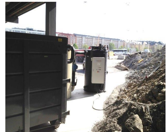
Abbildung 2: Wasservorlagebehälter der Anlage
