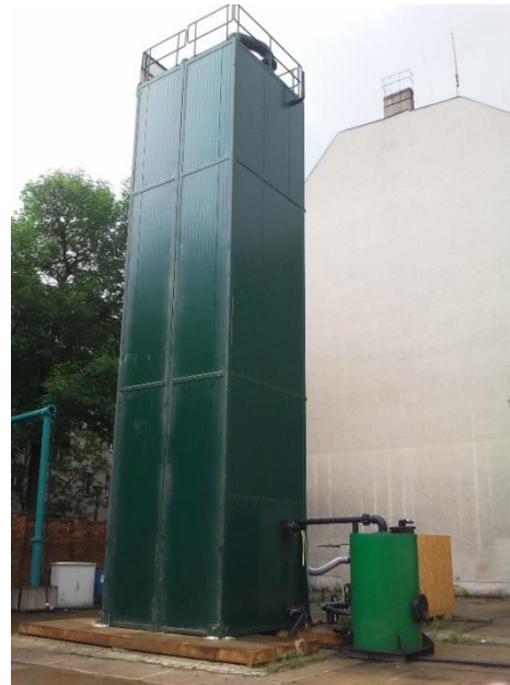
Abbildung 1: Grundwasserreinigungsanlage von LCKW, VC und BTEX
