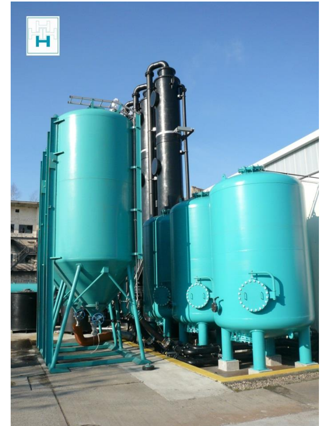
Abbildung 1: Grundwasserreinigungsanlage Berlin Chemie
