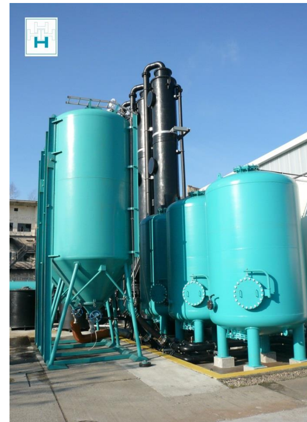
Grundwasserreinigungsanlage Berlin Chemie
